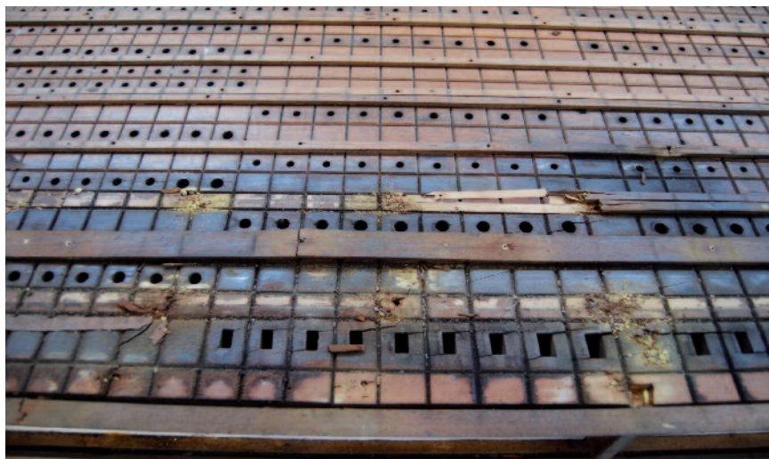
5. Somiere maestro, condizioni di degrado del pancone causate dall'infiltrazione di acido.
